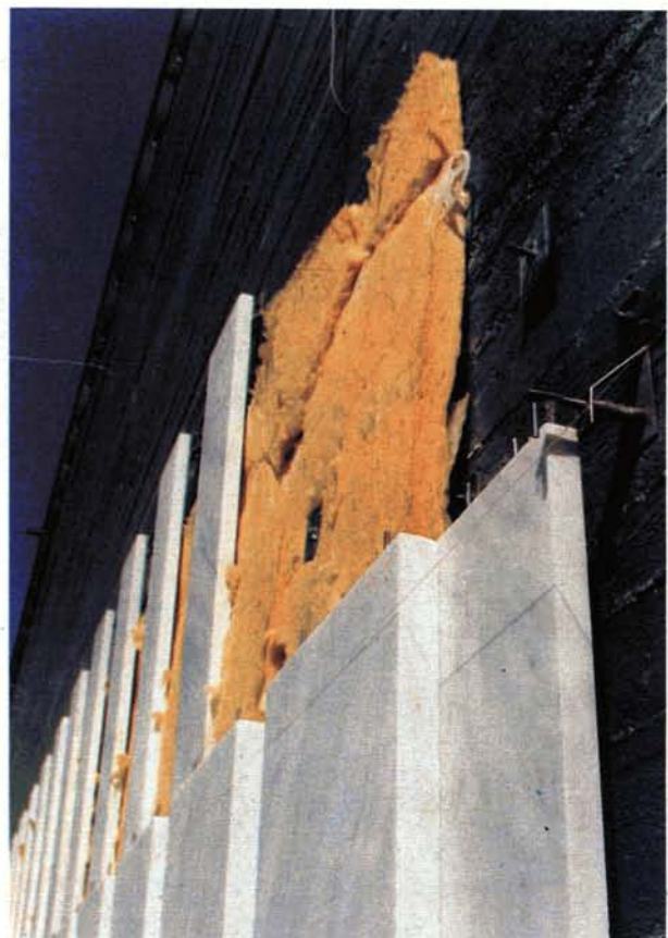
Σχ. 2.6ιγ. Επένδυση τοίχου με μαρμάρινες πλάκες (ορθομαρμάρωση). Διακρίνεται το θερμομονωτικό φύλλο που παρεμβάλλεται μεταξύ μαρμάρου και τοίχου και τα μεταλλικά στηρίγματα για την ασφαλή στερέωση της πλάκας.
